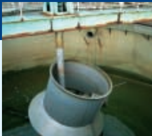
排水処理施設： 奥に破壊された導水管が見える
