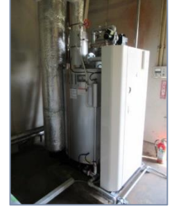
ガス炊きスチームボイラー
